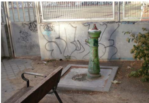
Fuente sin suministro en instalaciones deportivas de la calle Santa Hortensia
